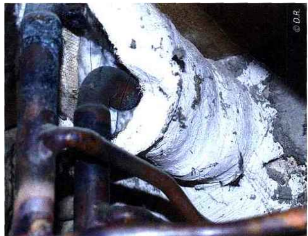
les canalisations anciennes sont souvent attaquées par la corrosion, ce qui favorise également l'installation du tartre, des bactéries, tout en diminuant sensiblement le rendement des installations
